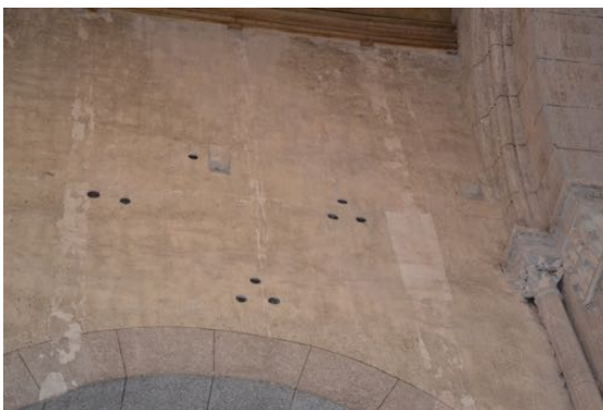
45 pots acoustiques disposés dans les murs de la nef
